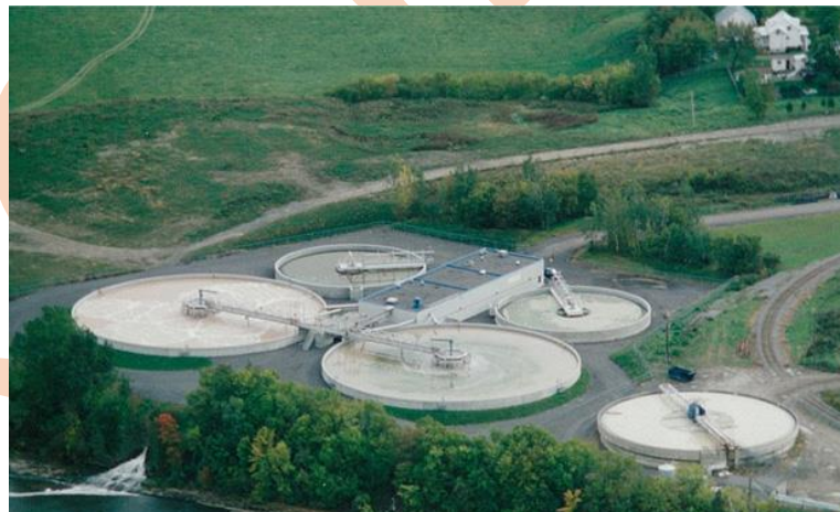
Figure 9 : La station d'épuration des eaux usées
