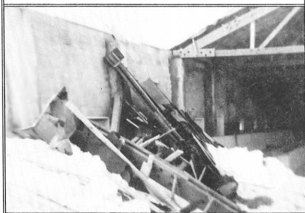
Un sinistre mémorable : deux vues de l'effondrement du toit de l'aréna en 1951
